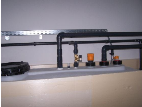
Solespeicher mit Heiztechnik
